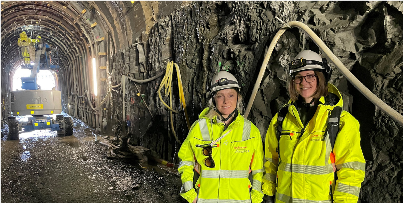
Kronstادتunnelen var under bygging i 2022. Gang- og sykkelunnelen er del av E39 Sykkelstamveg delstrekning 5 mellom Kristianborg og Bergen sentrum. Bybanen utbygging, her representert ved Camilla Einersen og Kristine Kjeilen, bygger sykkelstamvegen. Foto: Anders Kjetland
